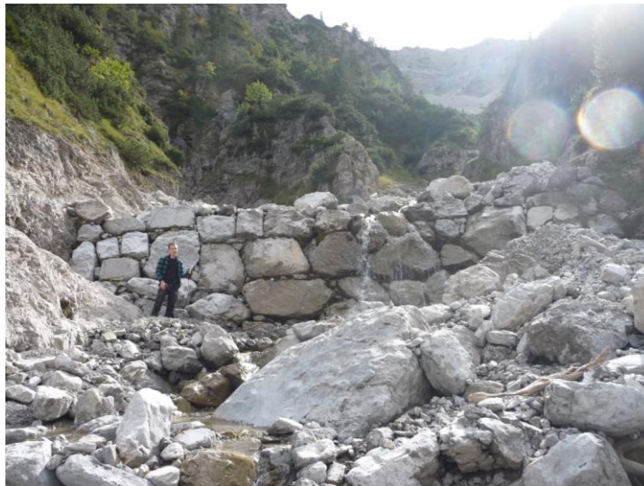
Abb. 2: Stark beschädigtes Sperrbauwerk im schlecht zugänglichen Oberlauf
