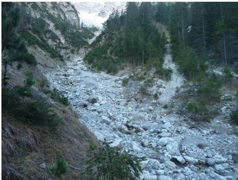
Abb. 4: Verbauungsabschnitt Nr. 6 mit weitgehend zerstörten Sperren
